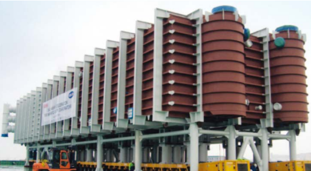
MED desalination plant
